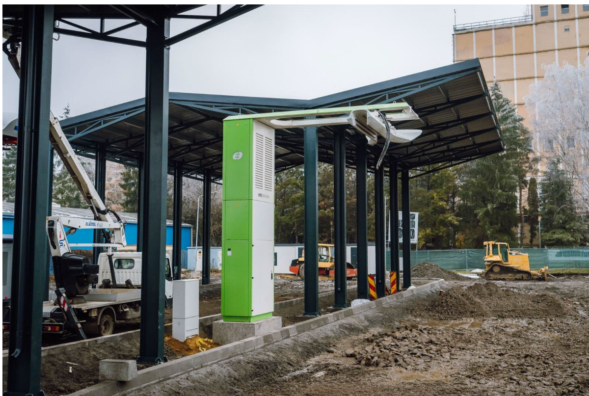
Stadiul lucrărilor la stațiile de încărcare la capătul de linie în data de 27 decembrie 2023. Poză preluată de pe pagina de Facebook al primarului Soós Zoltán.
